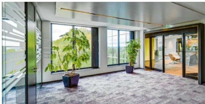
In dem Gebäude der VIB AG wurde im Innern eine Klima- und Akustikdecke von Metawell eingebaut. Foto: Metawell/oH
